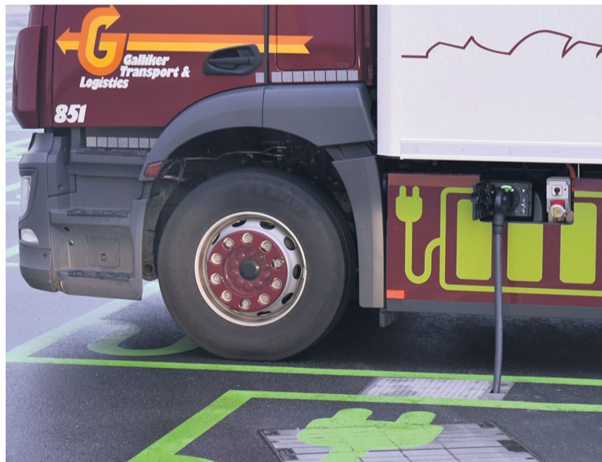
Auf dem Gelände der Galliker Transport AG befinden sich mehrere, zum grossen Teil im Boden montierte Ladestationen für E-LKW.
