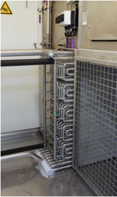
Tiefkühlverdampfer CO 2 mit Warmglykol, welches zur Abtauung aller Umluftkühler der Kühl- und Tiefkühlbereiche verwendet wird.
