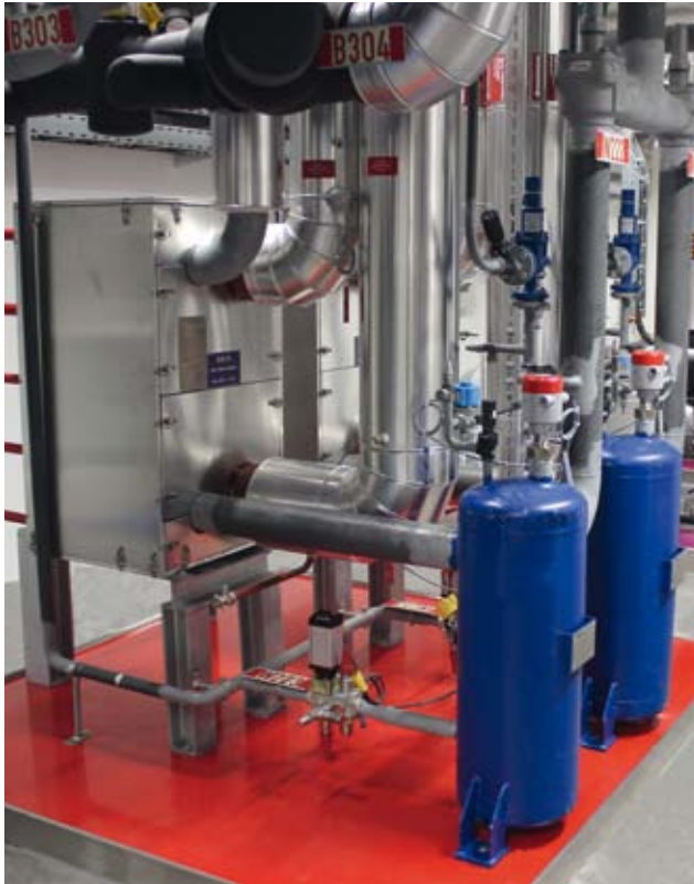
Abwärme wird in der Anlage konsequent genutzt, hier die beiden Plattenwärmetauscher.
