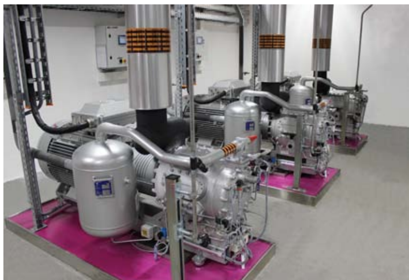
Die TK-Kälteverdichter mit CO 2 als Kältemittel.
