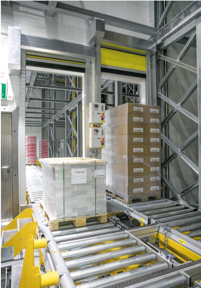
Zentrale Komponenten der Anlage sind die zu- und abführende Transportanlage, Verschiebewagen, Seilhubvorrichtungen, Paletten-etikettiersysteme sowie Schnelllauftore.
