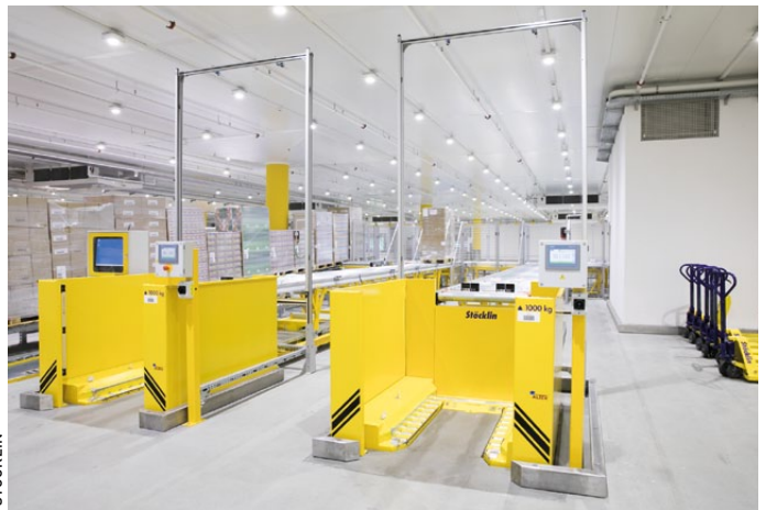
Die installierte Fördertechnik umfasst sowohl Rollen- als auch Kettenförderer, die die Paletten mit einem Tempo von 0,3 m/s sicher ans Ziel führen.
