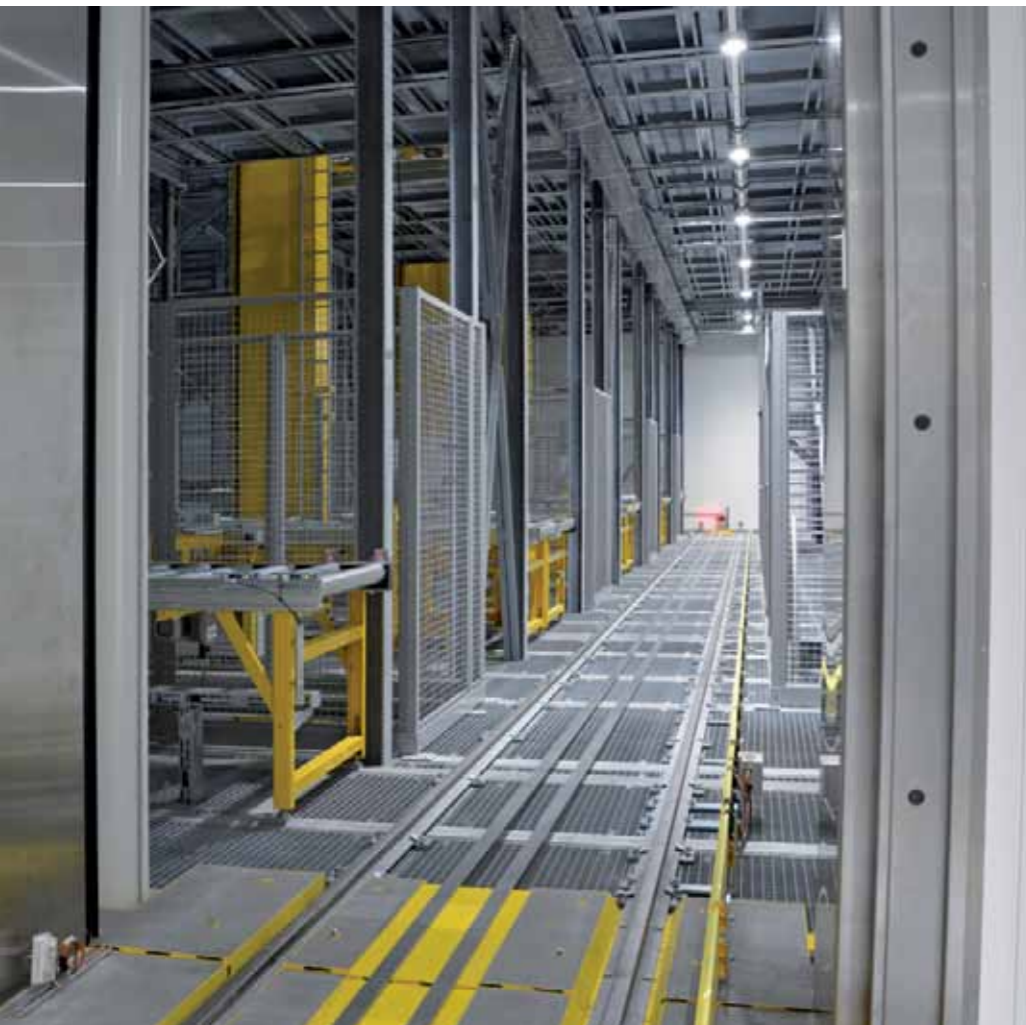
4 Als Brandschutzvorkehrung wurde im HRL eine Inertisierungsanlage mit Barrieren zur Vorzonen-Fördertechnik errichtet.
